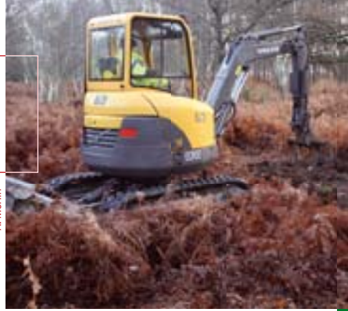
A. Morfin La préparation du terrain avec une mini-pelle équipée d'outils Becker est une des modalités étudiées.
