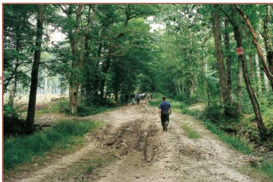
Voirie forestière dégradée
